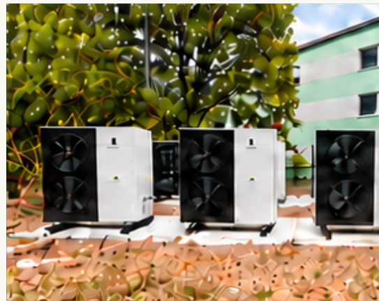
Pompes à chaleur
