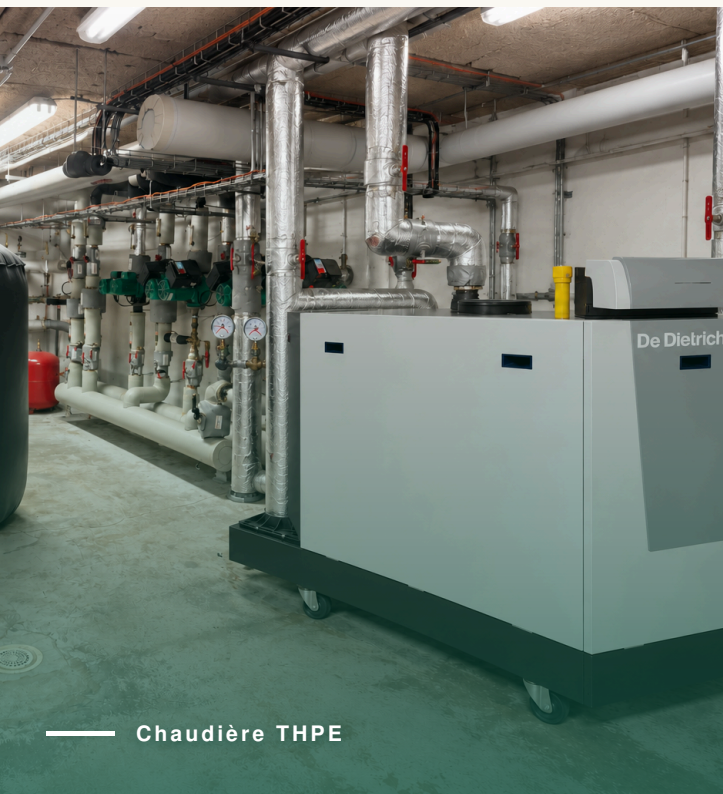
Pompes à chaleur
